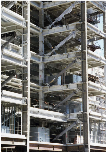
Figuur 3: Aardbevingsbestendig gemaakte staalconstructie. De diagonaal geplaatste dem-
